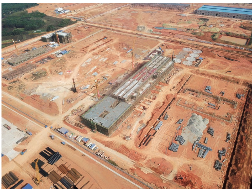
2019年,铁山港(临海)工业区内年产48万吨的川化优质钾肥项目动工兴建。图为施工现场 铁山港(临海)工业区管委会 供
