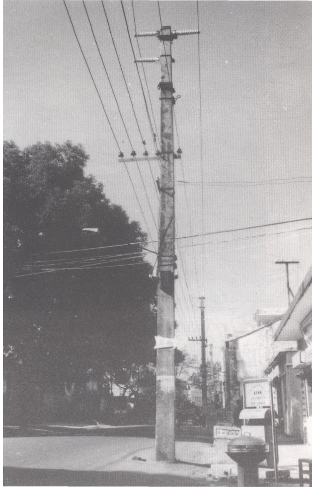
“衡兴隆”于20世纪30年代初在中山路建造的钢筋水泥方形电杆
